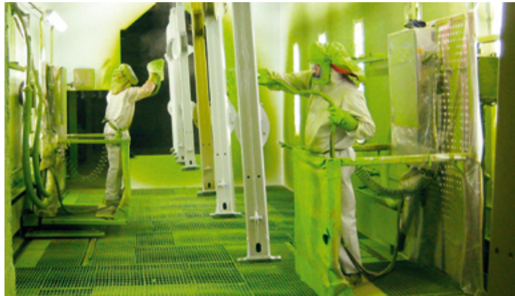
Die Lackierkabine beim Unternehmen Claas in Bad Saugau ist jetzt mit einer Trockenabscheidung ausgestattet.
